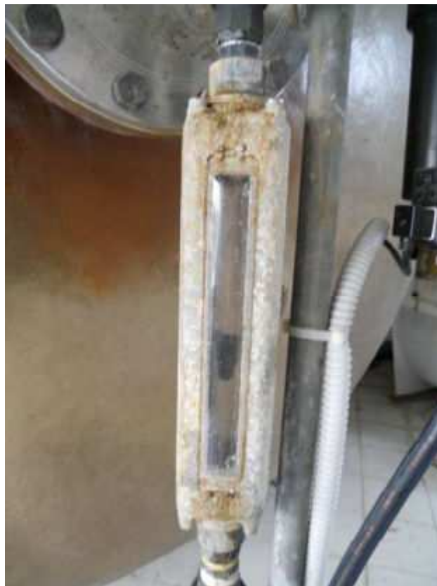
Flussimetro dopo la pulizia iniziale
