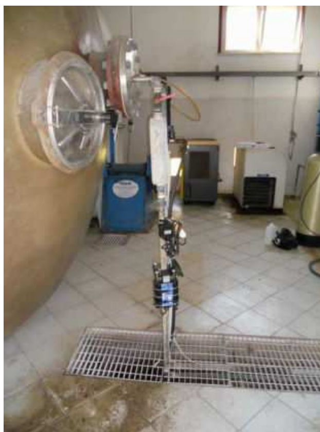
Visione di insieme dell'impianto con apparecchio installato.
