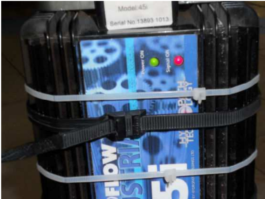
Hydropath messo in funzione (led accesi).
