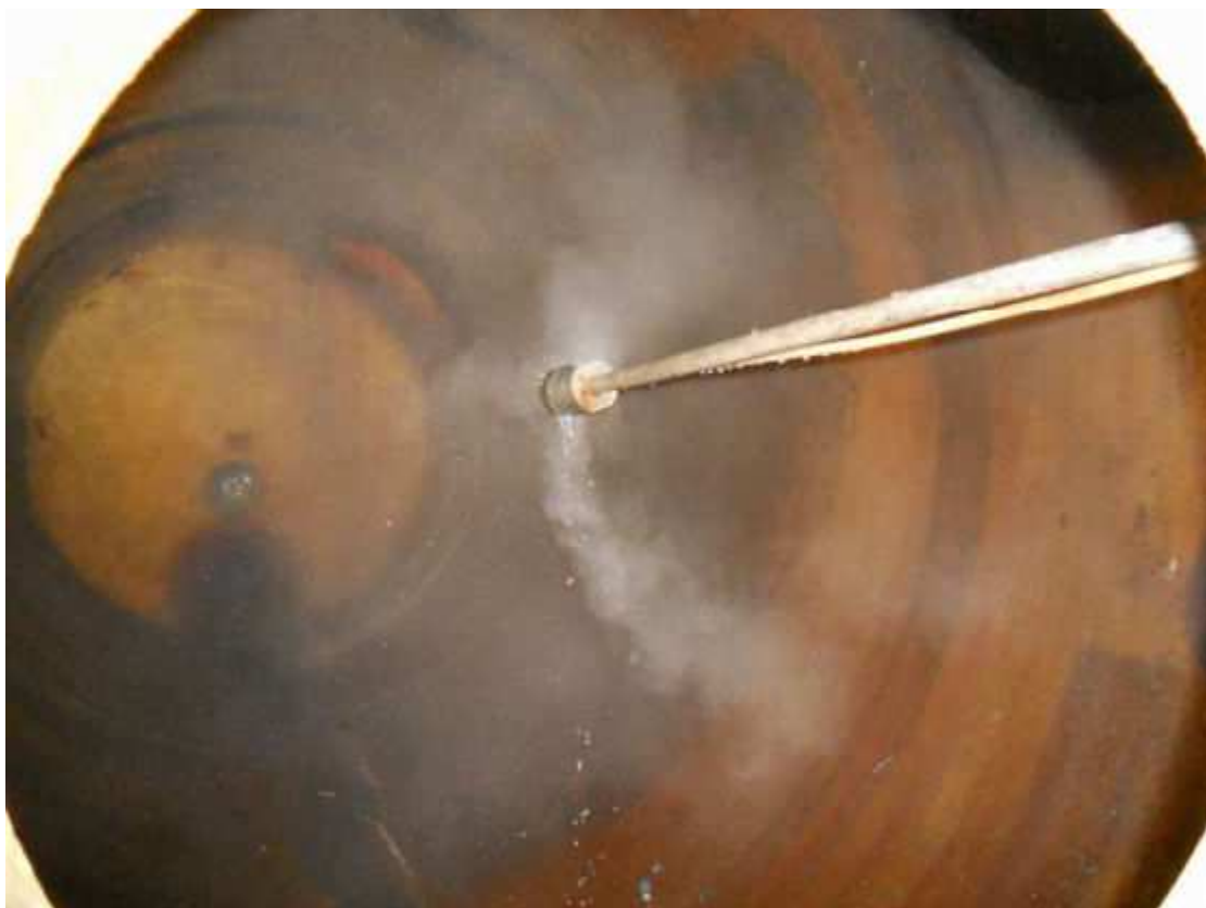
Interno camera deodorizzazione, flusso nebulizzato.
